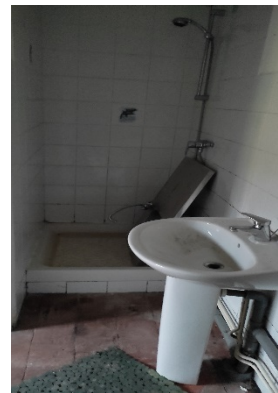
la salle de bains
